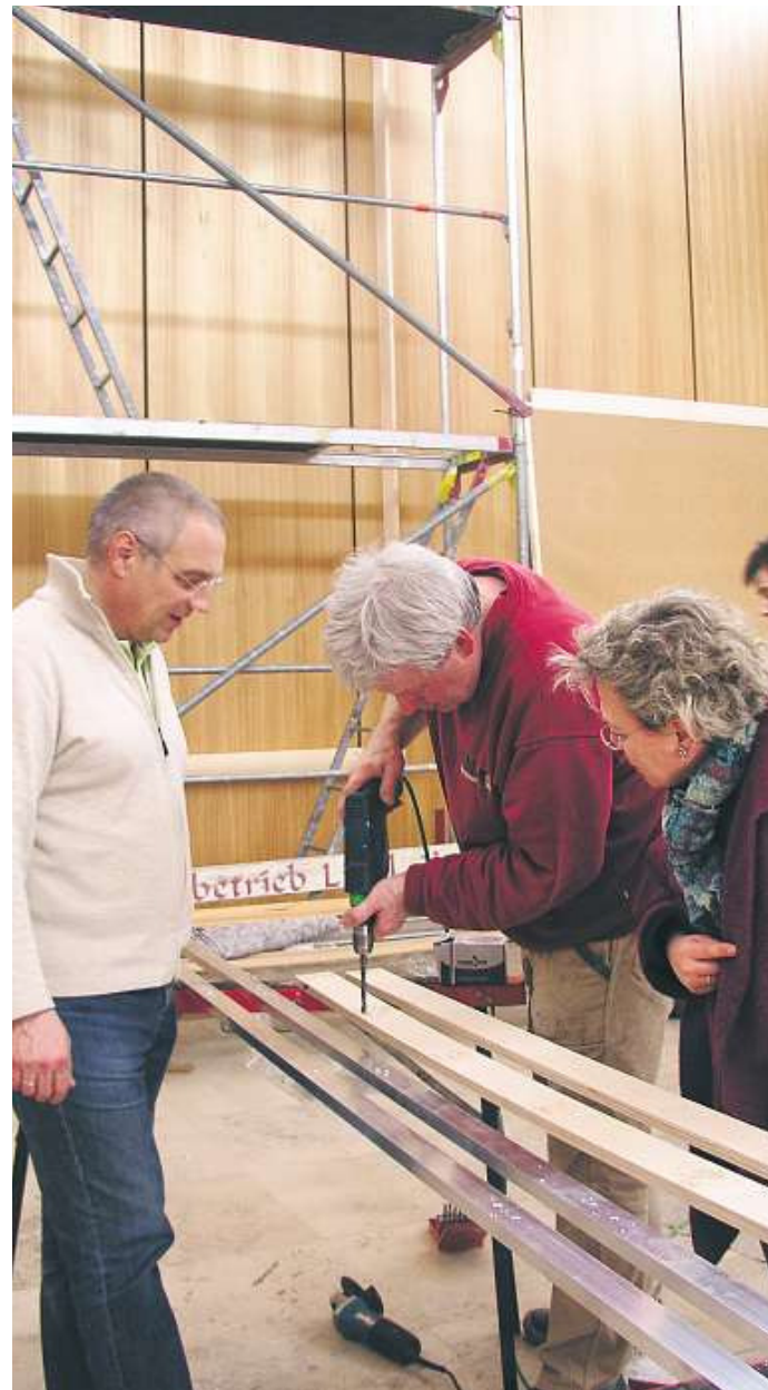
Dicke Bretter bohren: Pfarrerin Dr. Bärbel Mayer-Schärtel und Architekt Ricco Johansen dürfen zuschauen. Foto: er
