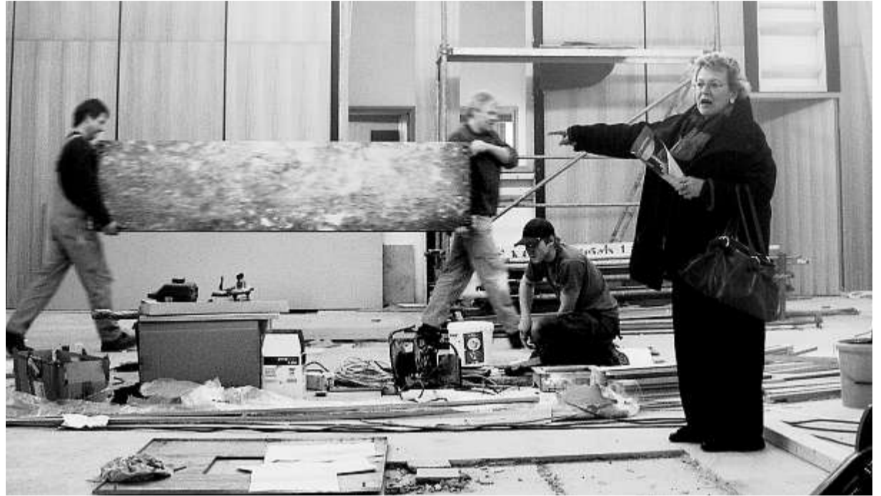
„Jawohl, meine Herrn, so haben wir das gern!“ — Pfarrerin Dr. Bärbel Mayer-Schärtel auf „ihrer“ Baustelle Foto: er
